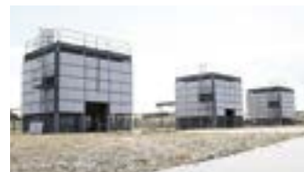
天然ガス生産井
